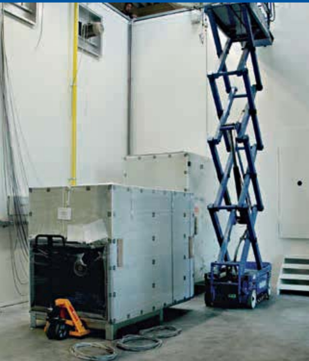
Vormontierte Klimageräte für das Deckendepot.
